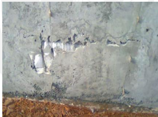
Figura 5.13. Cangrejera en muro perimetral con exposición de acero y aislante térmico
