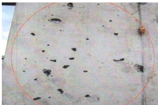
Figura 5.14. Presencia de burbujas en el concreto de un muro perimetral
