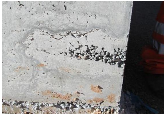
Figura 5.12. Segregación de un muro de ductilidad limitada
