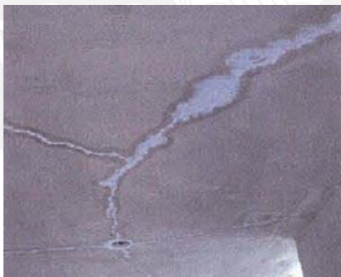
Figura 5.15. Presencia de fisuras en losa
