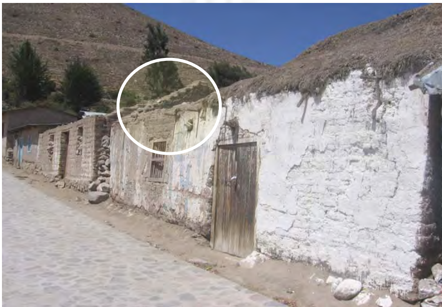
Figura N° 17: Muros superiores con “adobes antiguos” en Calle San Francisco. (Fotografía: Carlos Choque)
