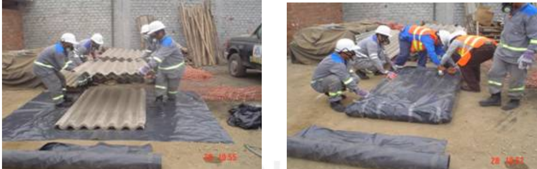
Figura 35. Disposición de Material con Asbesto
