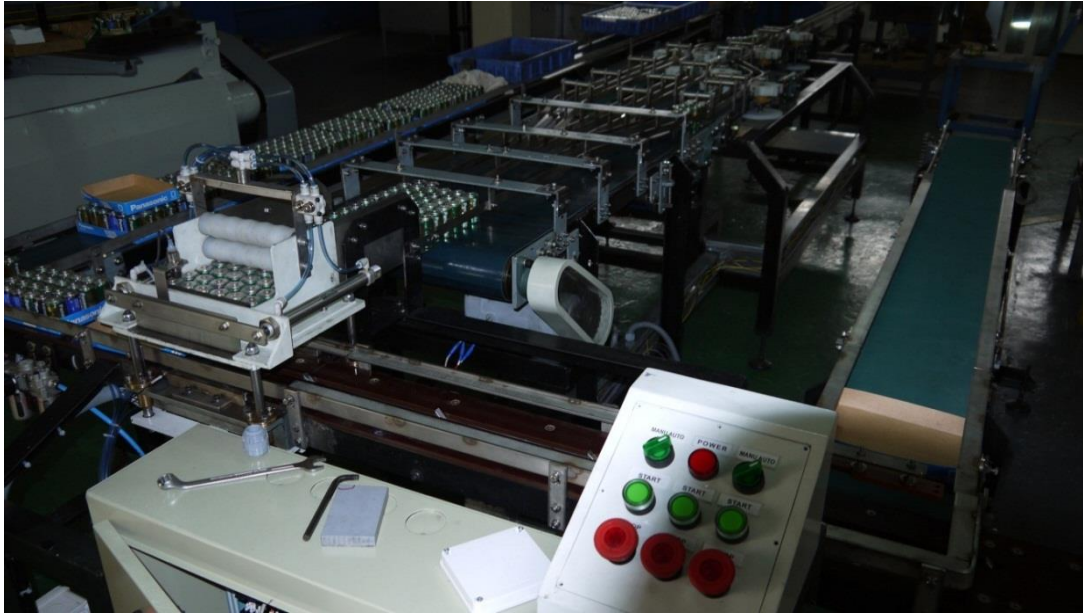
Figura 5-18: Vista del tablero de mando; botones, luces indicadoras, selectores de modo manual/automático y hongos de emergencia
