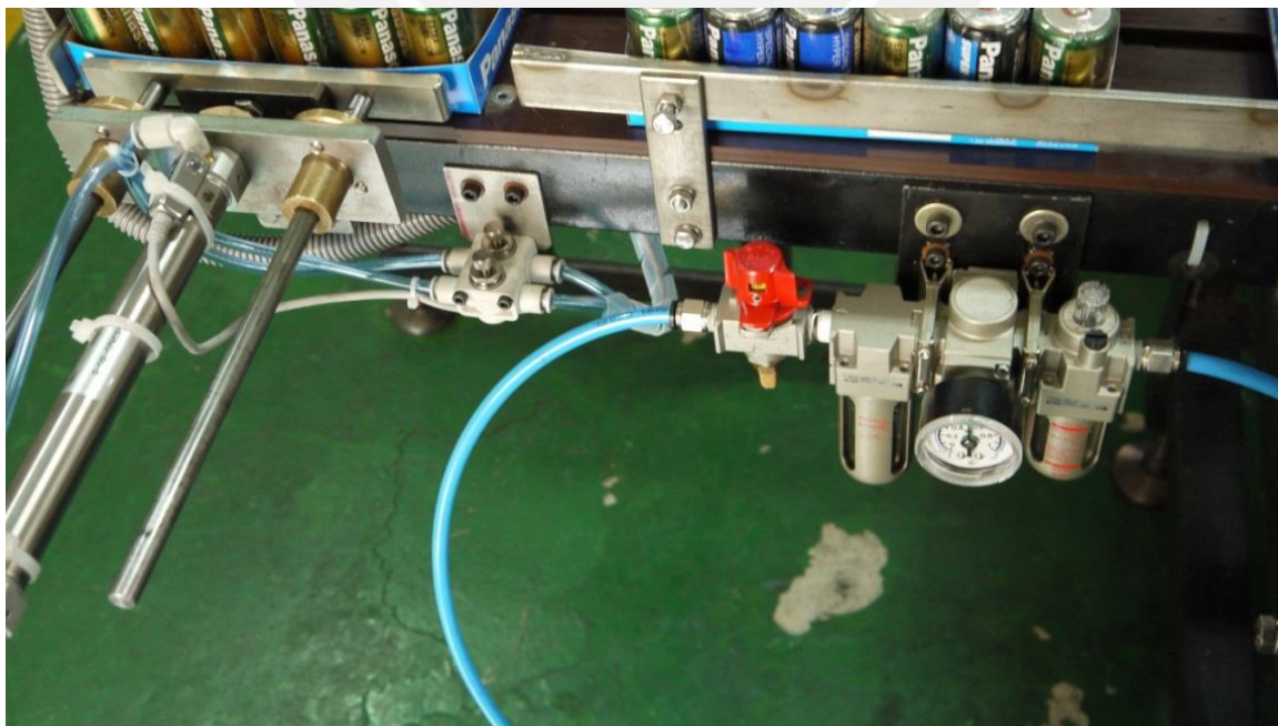
Figura 5-10: Ingreso de aire comprimido al conjunto: válvula manual 3/2 con enclavamiento y FRL.
