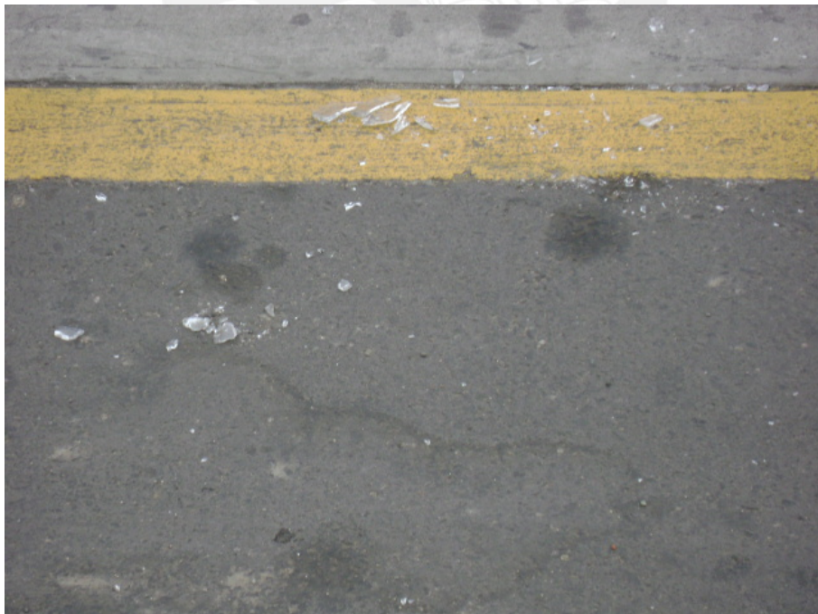
Fotografía 4. Pedazos de vidrios rotos a lo largo de un tramo en la ciclovía.
