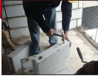
Figura 5.56. Apertura de alveolo con refuerzo vertical y colocación de la primera hilada
