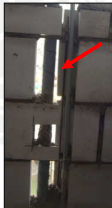
Figura 5.48. Espacio vacío entre bloque y tubería.
