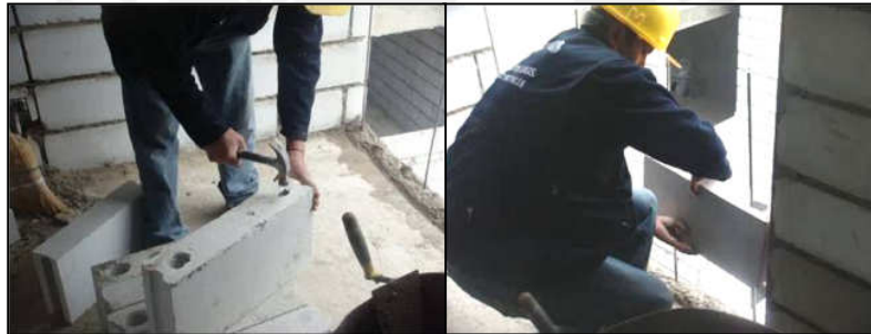
Figura 5.8. Apertura de alveolo con refuerzo vertical y colocación de la primera hilada
