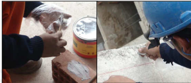
Figura 5.37. Aplicación de epóxico en agujeros de la Placa P10 y en el refuerzo vertical.
