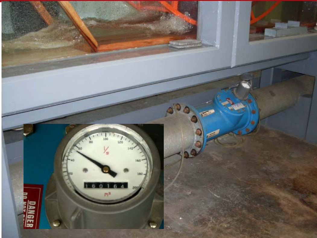
Figura 3.4: Medidor de Caudal
