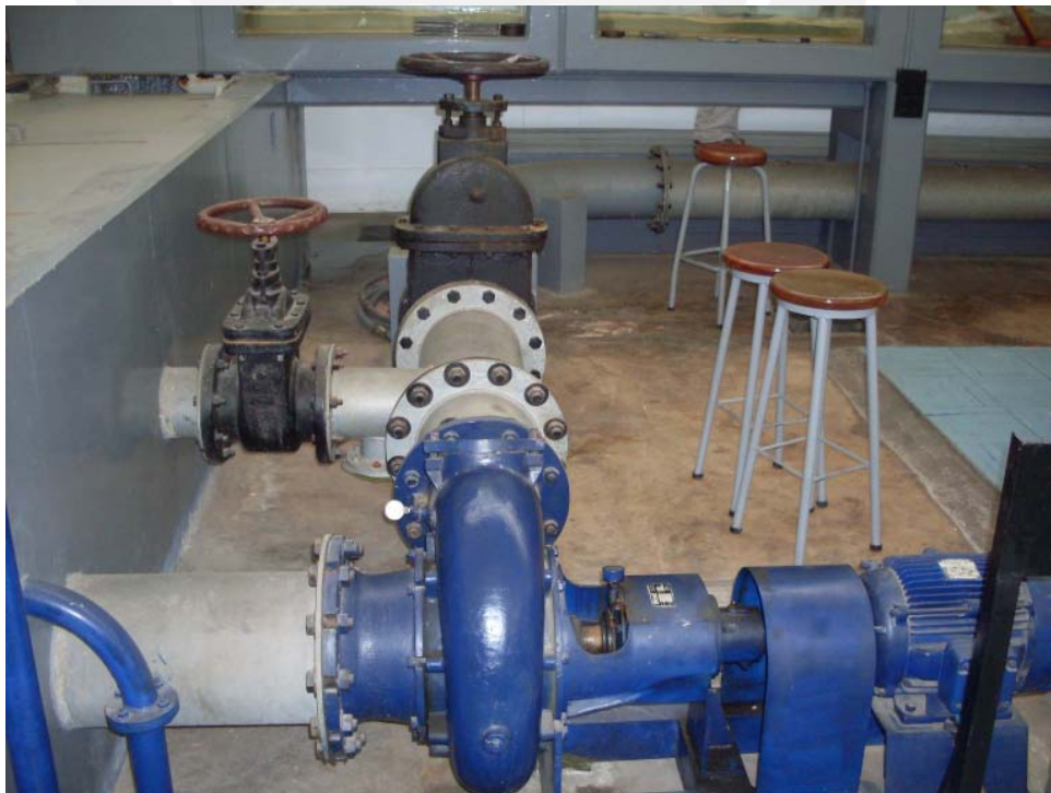
Figura 3.3: Bomba Centrífuga de impulsión (Hidrostral – motor 6 HP)
