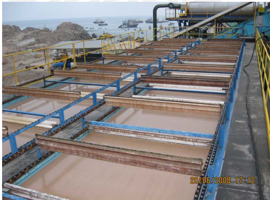
Fig.1.13. Skimmer recolector de Espuma arrastrada al cajón recolector
