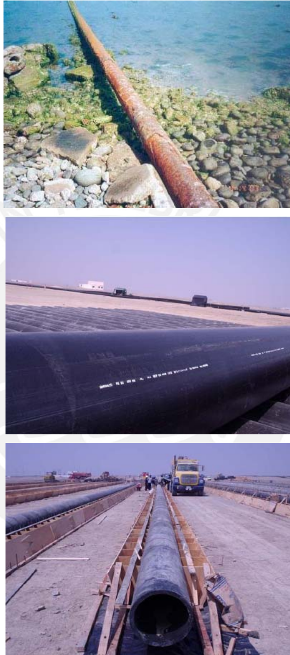
Fig. 3.4. Tuberías de pescado fierro y HDPE
