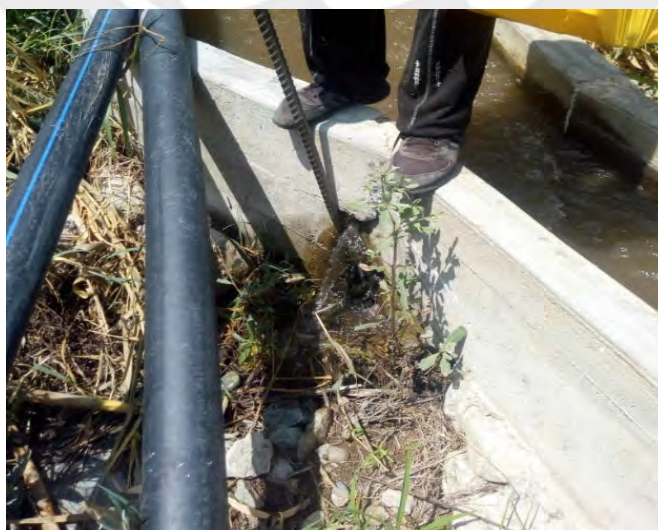
Figura 72. Filtración de agua por malas juntas.
