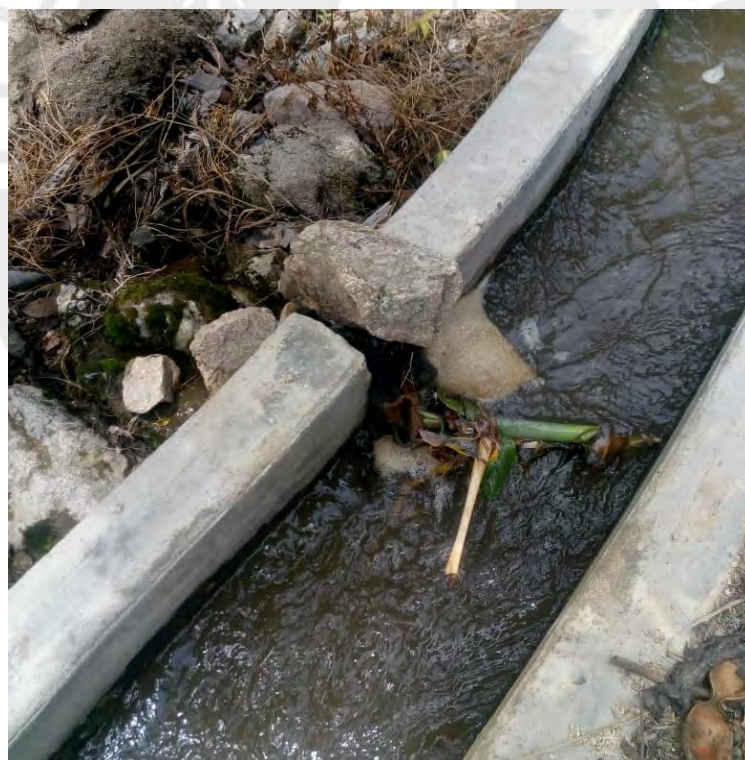
Figura 74. Rajaduras y canal roto.
