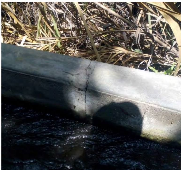
Figura 73. Rajaduras en el canal.
