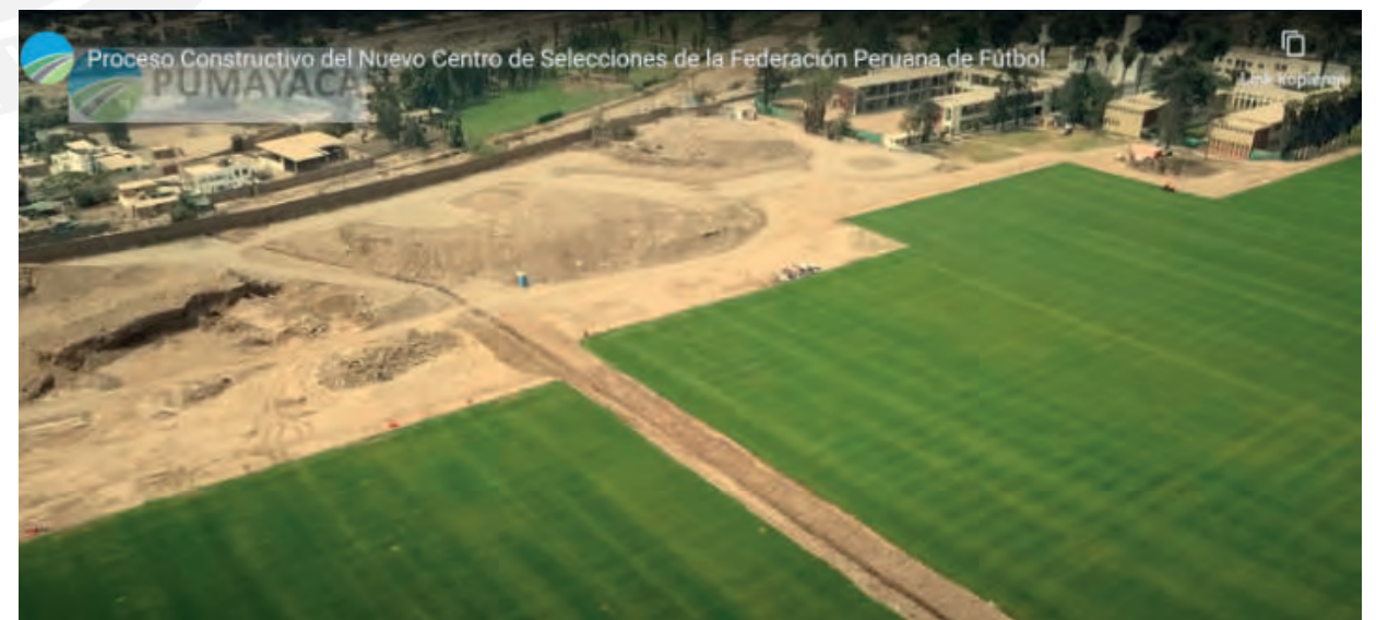
Figura 47 Título: Fotografía aérea proceso de construcción canchas reglamentarias Centro deportivo FPP Fuente: Lozano & Cía: el abandono de La Nueva Videna 2022
