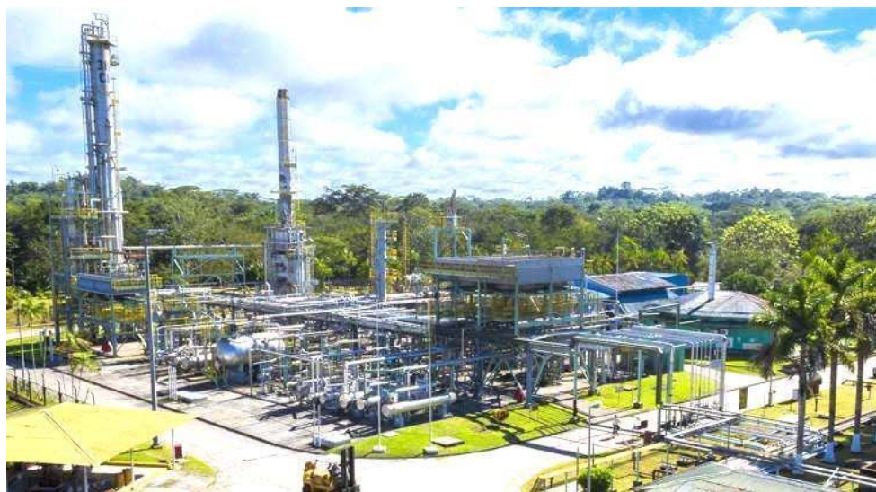
Figura 15. Vista Aérea de la Refinería Iquitos, Departamento de Loreto.
