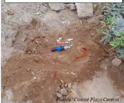
Punto de agua secundario en parque Plaza Central
