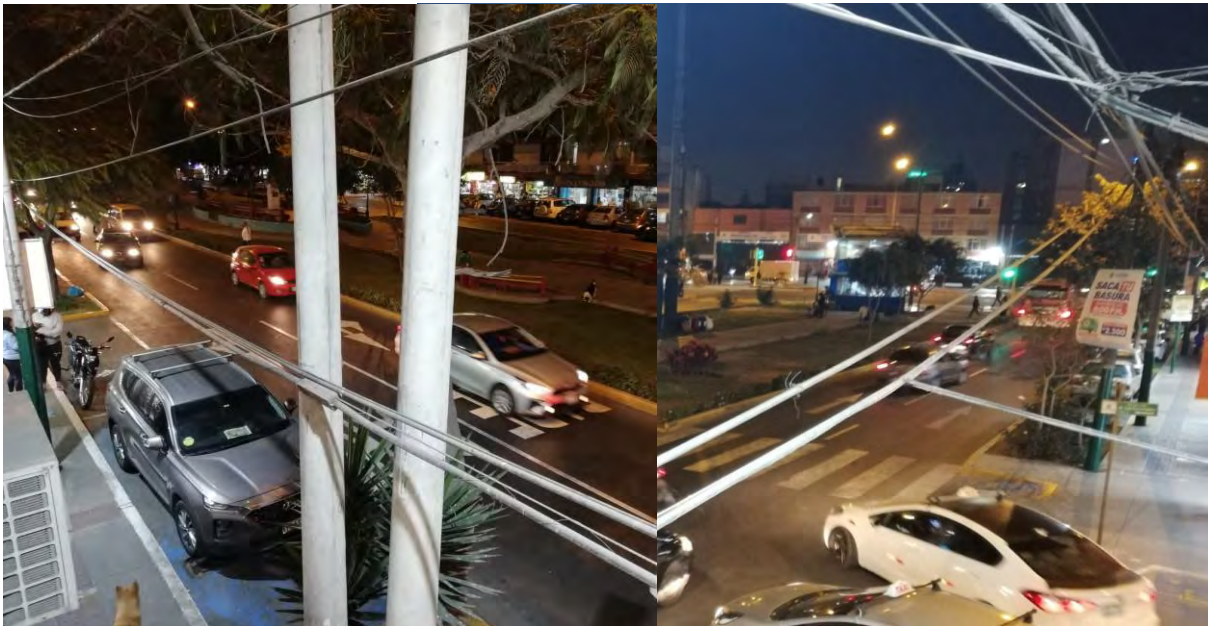
Figura 53. Desorden visual debido al excesivo cableado. Fuente: Propia
