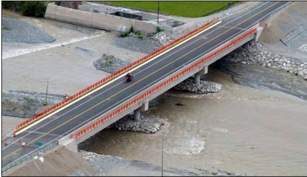
Figura 2 Vista del puente Freyre sobre el rio Tambo. Fuente, Ministerio de Transportes y Comunicaciones
