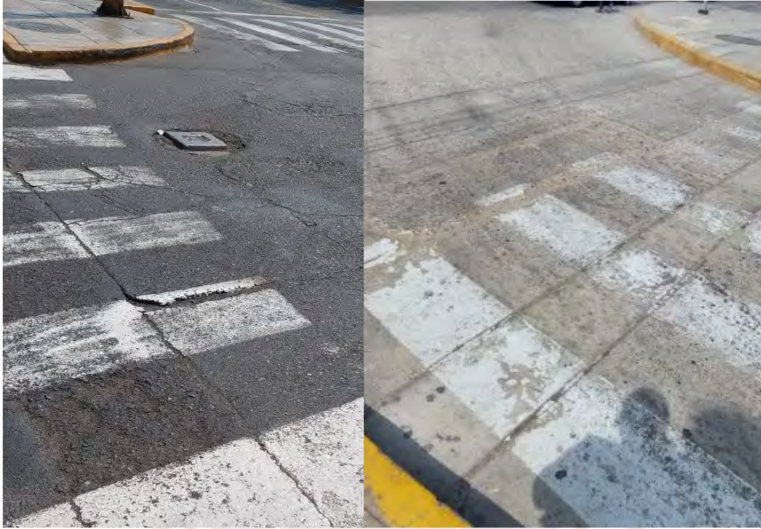
Figura 43. Estado de la pista.
