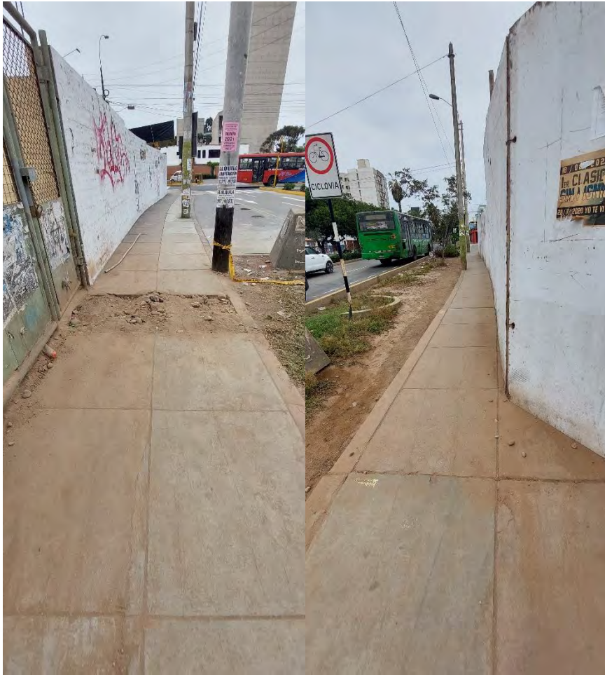
Figura 52. Obstáculos y dimensiones reducidas en las veredas.
