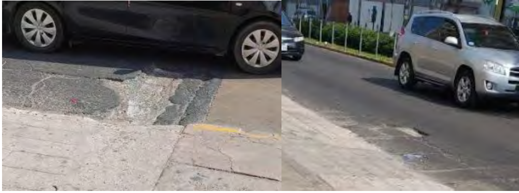
Figura 32. Estado de la pista
