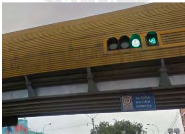
Figura 1.3: Suciedad acumulada en exteriores de estructuras . Extraído de Google Maps, 2023.
