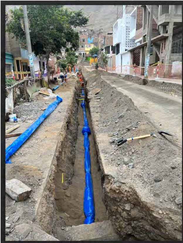
Foto 14: Tubería de hierro dúctil recubierta instalada (1er Muestreo – 19/04/23)
