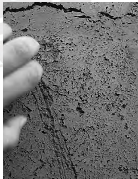
Figura 2. Superficie de concreto con baja resistencia Elaboración propia
