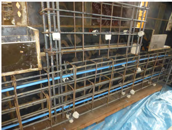
Figura 3.8: Tendones de postensado
