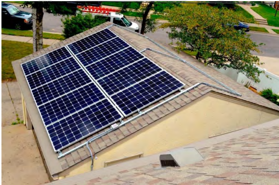
Figura 1.10. Sistema fotovoltaico sobre tejado
