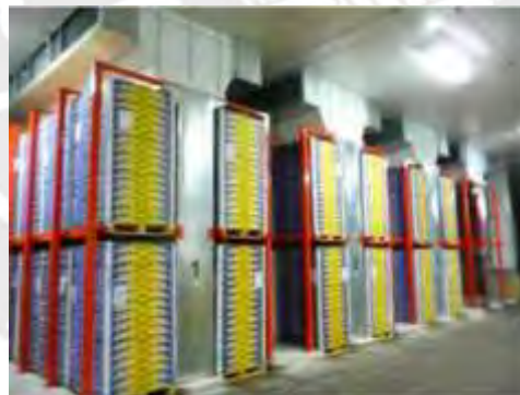
Figura 1.3 Enfriador de aire forzado vertical Nota. Tomado de “Efficient Fruit and Vegetables Processing Plants Handbook”, por tesla (2014)
