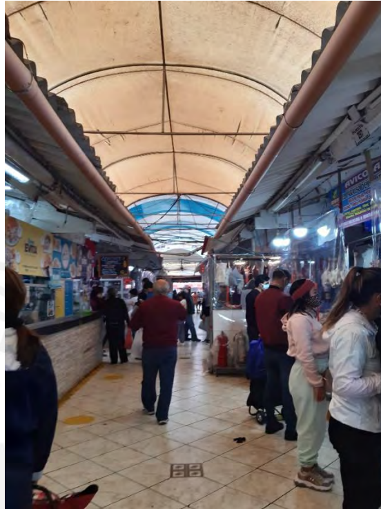
Imagen 10. Cubierta metálica translúcida y obstaculización de los pasadizos con la ampliación de puestos en el mercado San José. Fuente propia.
