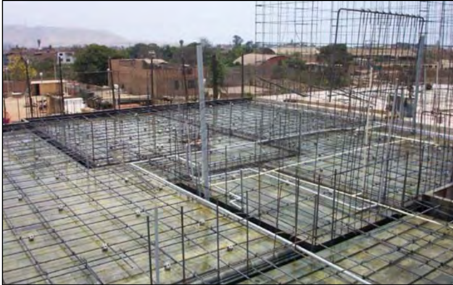
Figura 20. Losa de contrapiso de MDDL.
