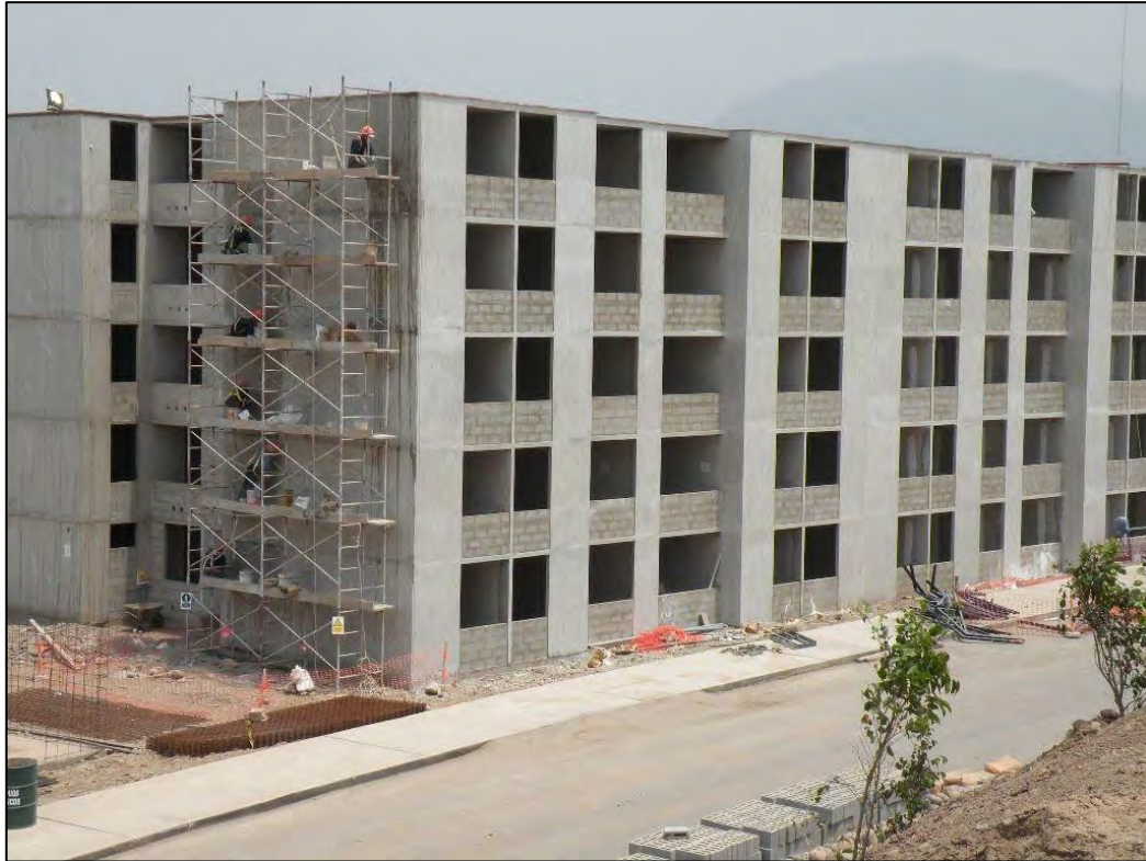
Figura 18. Casco de un edificio con el sistema de muros de ductilidad limitada.
