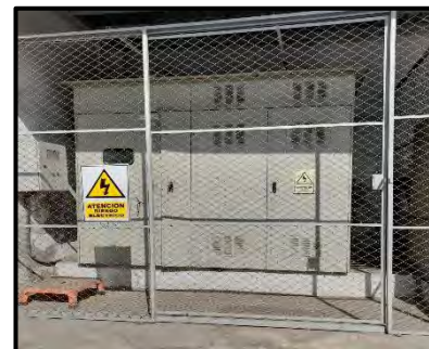
Figura 19: Transformador eléctrico Fuente: Empresa
