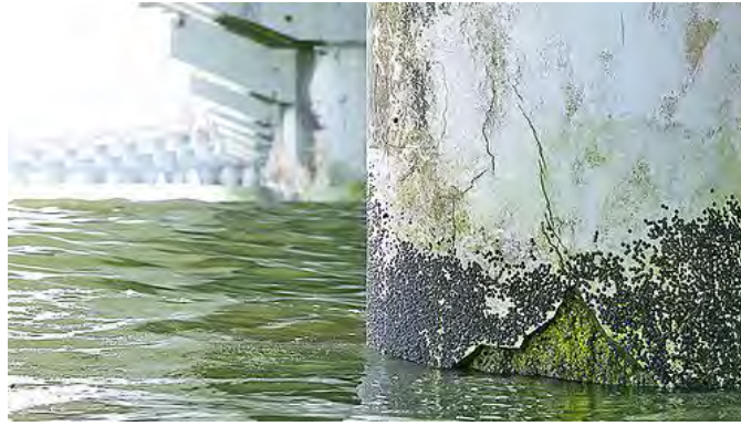
Figura 9. Corrosión del hormigón armado. Corrosión debido a la exposición del material al medio ambiente marino, se aprecia que la zona sumergida y la zona de marea, son las más afectadas por su exposición constante al propio ambiente (Flores, 2020).
