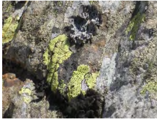
Figura 4. Desarrollo de musgo y líquenes en el hormigón biológico. Estas alteraciones en la capa del hormigón, proporcionan que la cara superficial presente un aspecto ornamental y mejora estética por las variaciones a lo largo del año (Noguera, 2013).
