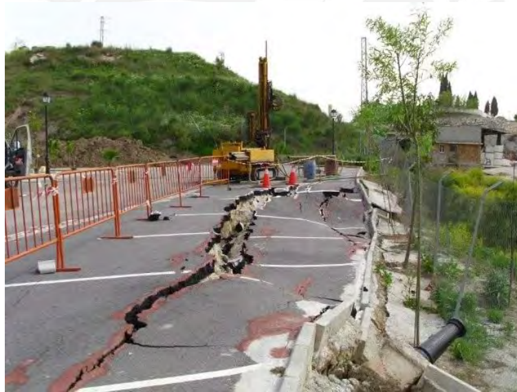
Figura 1. Falla en pavimentación. Falla generada por inestabilidad de suelo (Hurtado, 2017).
