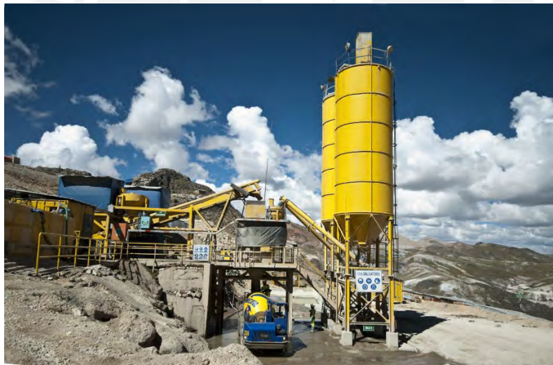
Figura 9. Planta mezcladora instalada por la empresa UNICON
