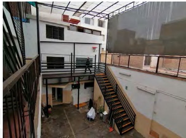
Figura 153. Escalera metálica primer nivel 2 Fuente: Producción propia
