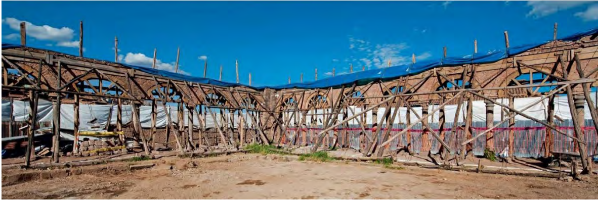
Figura N°4. Vista interior durante el proceso de conservación los arcos coloniales del patio, así como se observa que el edificio contaba con sólo 1 nivel hacia el interior . Fuente: Beatriz Velarde, JW Marriot Cusco .
