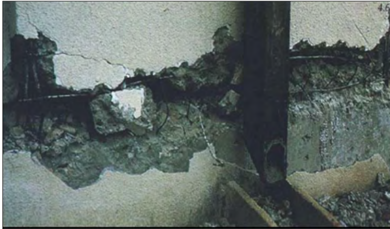
Figura 19. Falla por flexión que generó deslizamiento (San Bartolomé, 2010)
