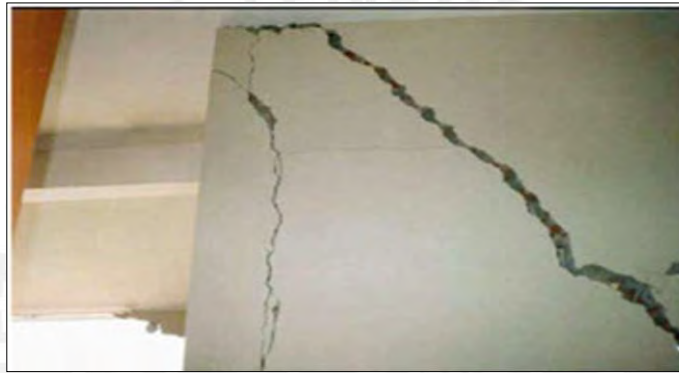
Figura 18. Falla por corte en muro (Aceros Arequipa, 2020)
