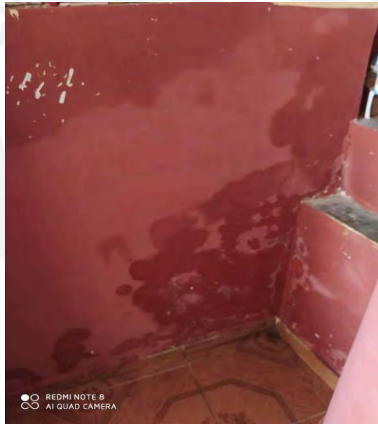
Humedad en muro
