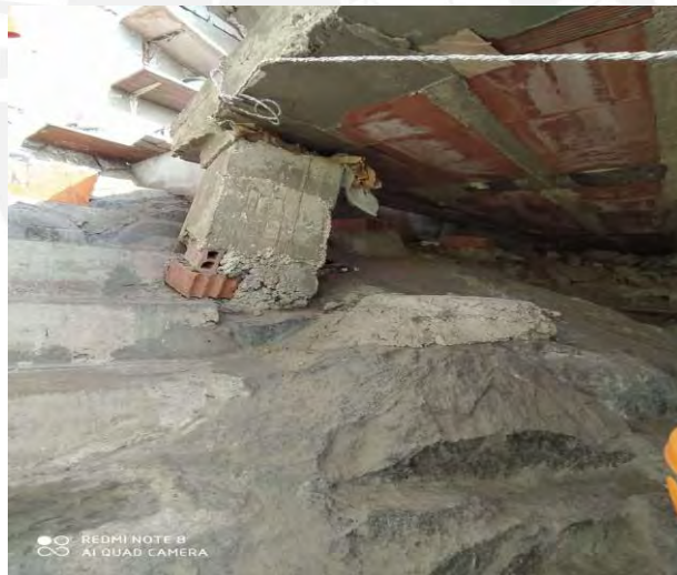
Mala calidad de mano de obra y materiales
