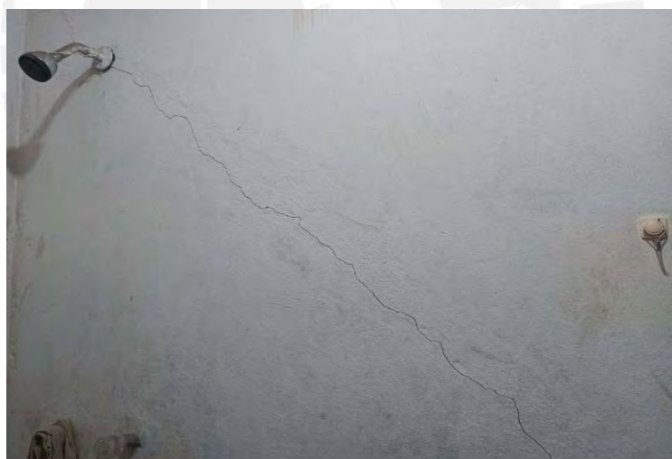
Falla estructural en muro
