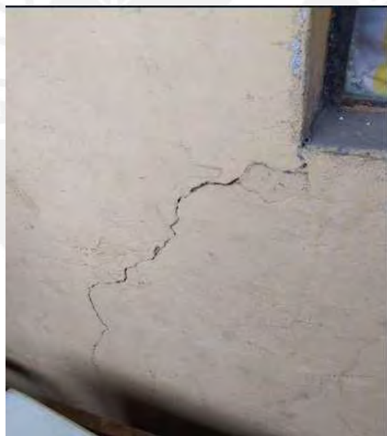
Falla estructural de muro
