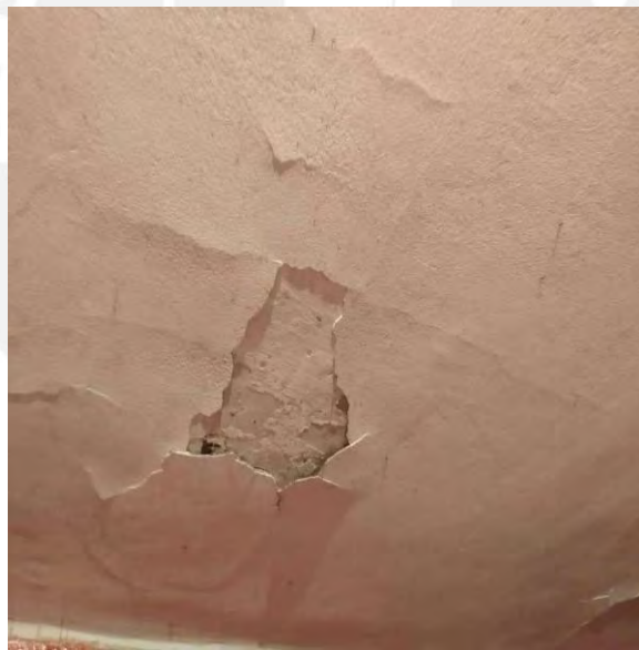
Humedad en techo
