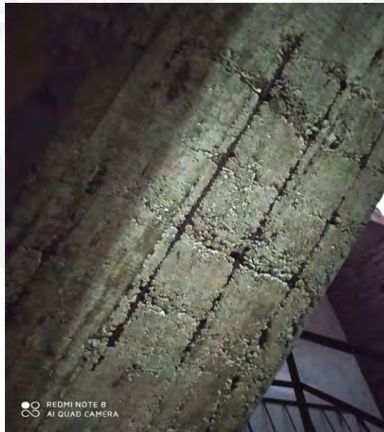
Armaduras expuestas en columna
