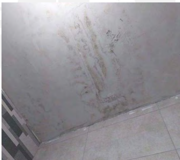
Humedad en techo
