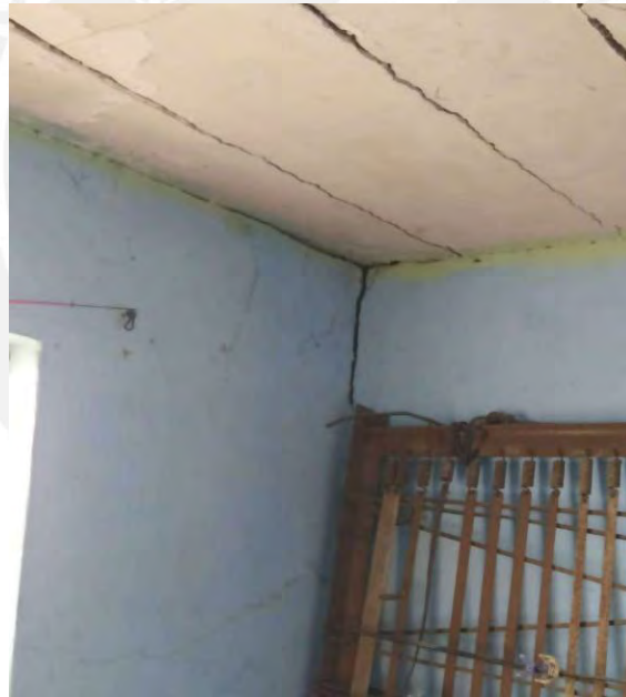
Falla en techo
