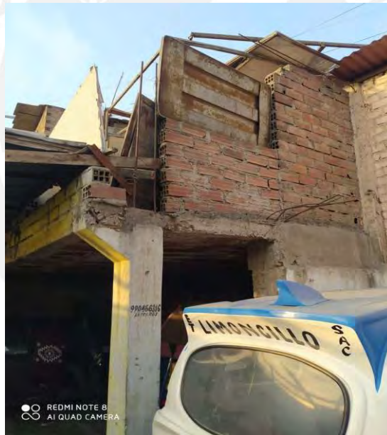
Tabiquería no arriostrada
