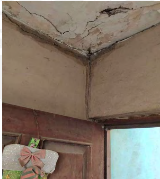
Humedad en techo
