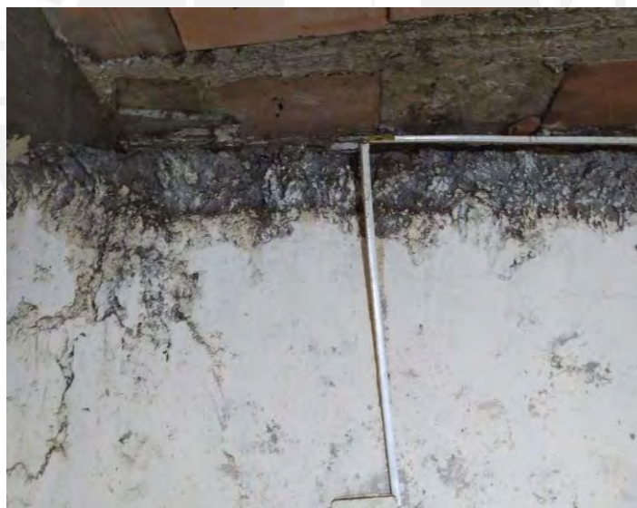
Humedad en muro
