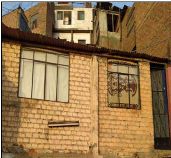
Figura 38. Tabiquería no arriostrada
