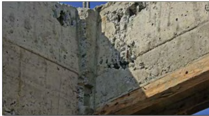
Figura 13. Formación de cangrejas en elementos estructurales (Aceros Arequipa, 2021)
