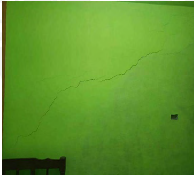
Falla estructural de muro
