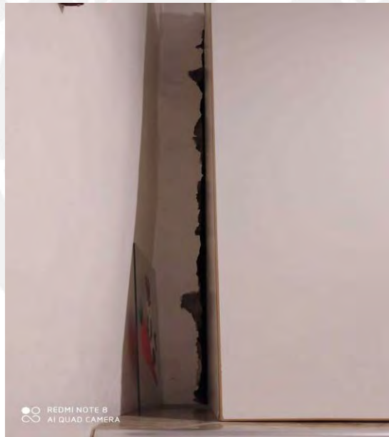
Agrietamiento en muros
