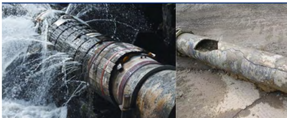
Figura 2-13 Tuberías rotas por golpe de ariete
