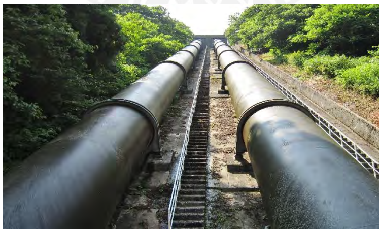
Figura 2-8 Tubería forzada de acero en central hidroeléctrica Kanidera
