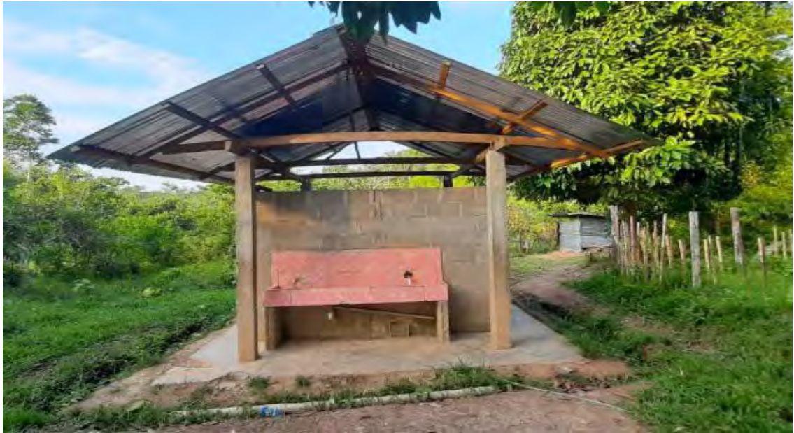
Figura 16 : Caños en desuso
