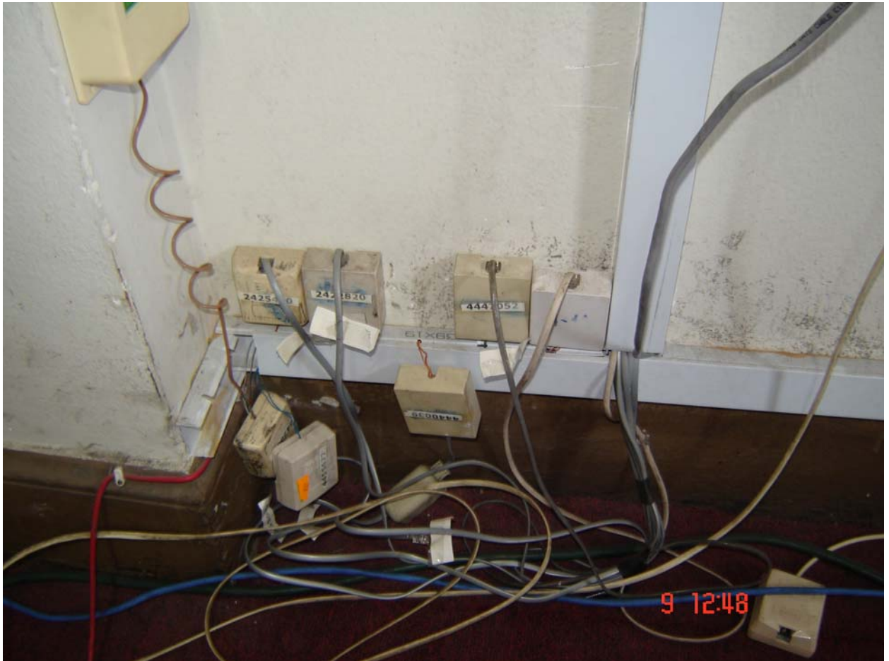
Foto No. 2: Líneas telefónicas que llegan a la central
