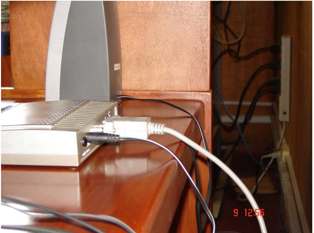
Foto No. 9: Cable serial que sale del módem hacia la PC (IVR)
