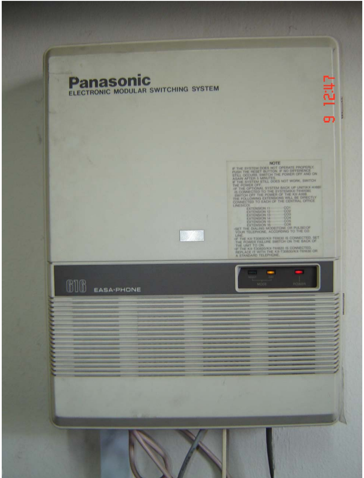
Foto No. 4: Central telefónica Panasonic – vista de cerca
