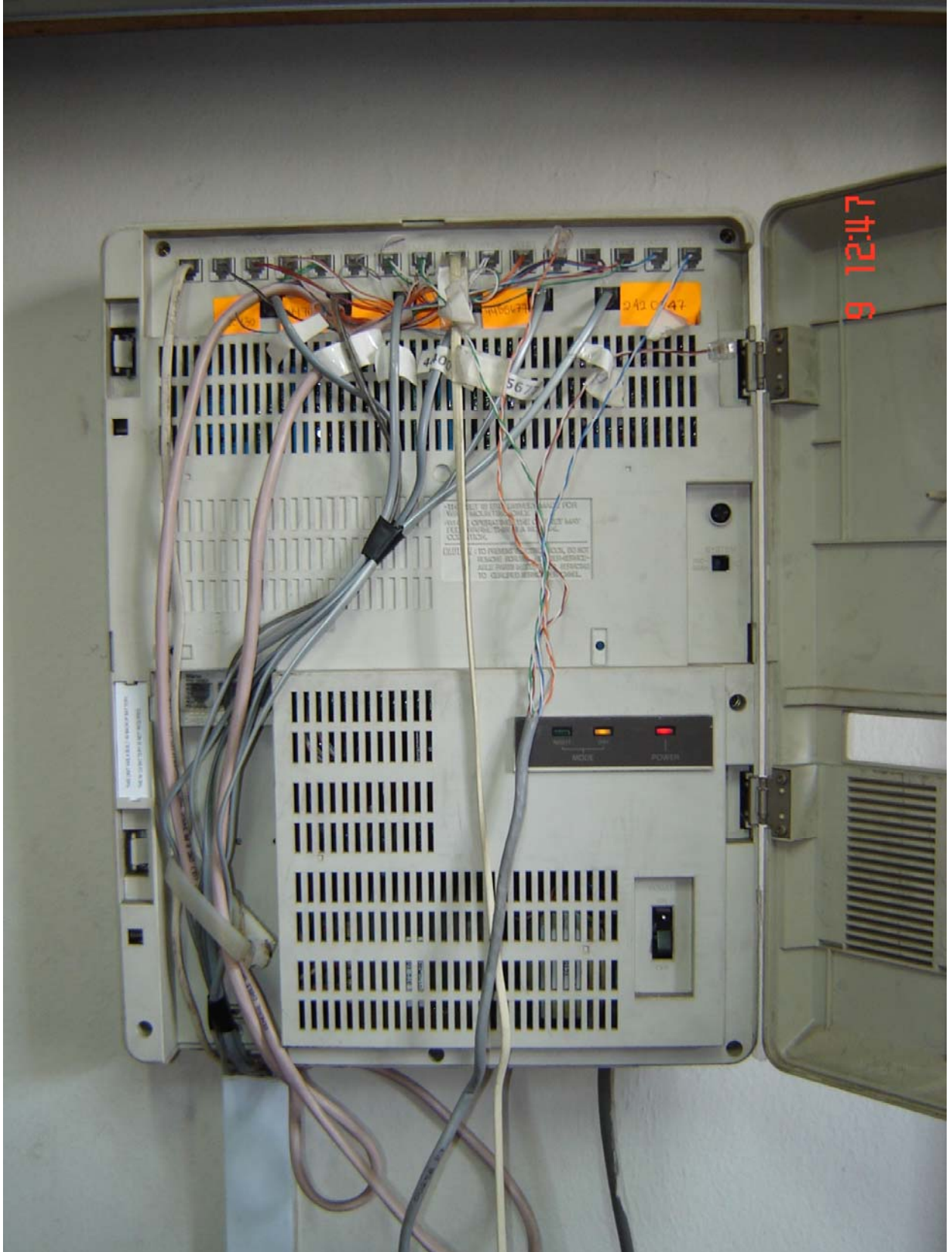
Foto No. 5: Central telefónica – vista interior
