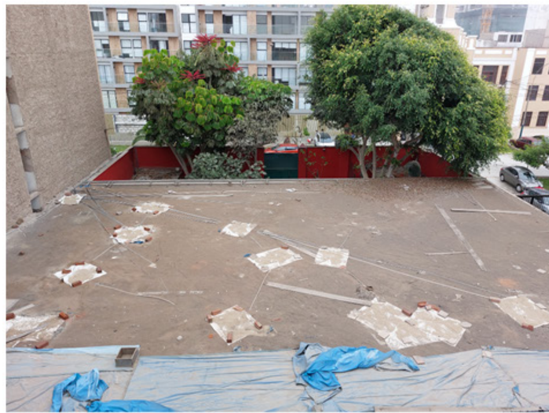
Techo de barro de la casona con perforaciones
