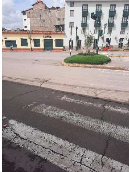
Figura 19. Cruceo peatonal sin mantenimiento de la avenida Tullumayo. Fuente: propia
