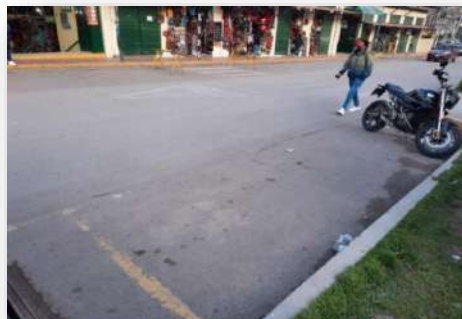
Foto 80: Demarcaciones horizontales desgastadas en la zona de estacionamiento, avenida Tulumayo.
