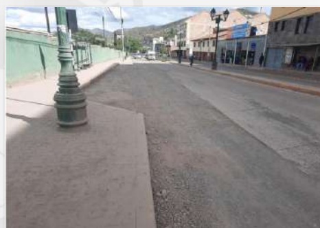
Foto 64: Material suelto en carril derecho de acceso de la alameda Pachacutec.
