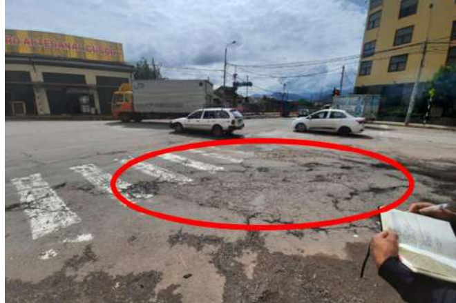
Figura 23. Agrietamiento tipo "Piel de Cocodrilo" en el pavimento de la avenida Pardo - Paseo de los Héroes.
