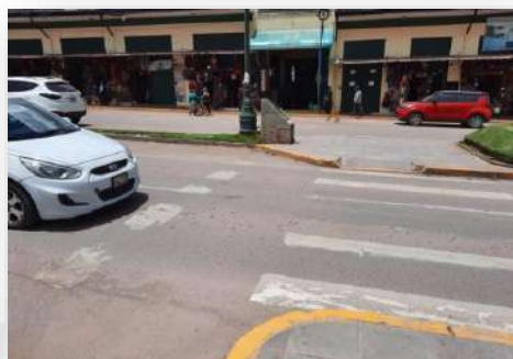
Foto 26: Líneas de parada de vehículos desgastada en la avenida Tullumayo.
