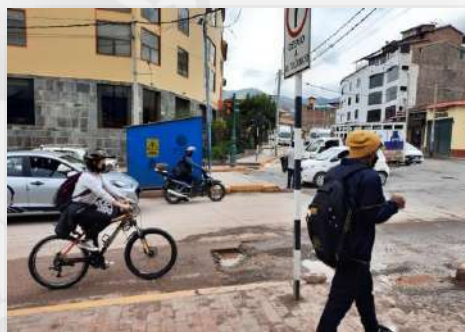
Foto 130: Carril derecho deteriorado en la alameda Pachacutec.
