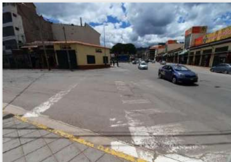
Foto 25: Líneas de parada de vehículos desgastada en la avenida Pardo.
