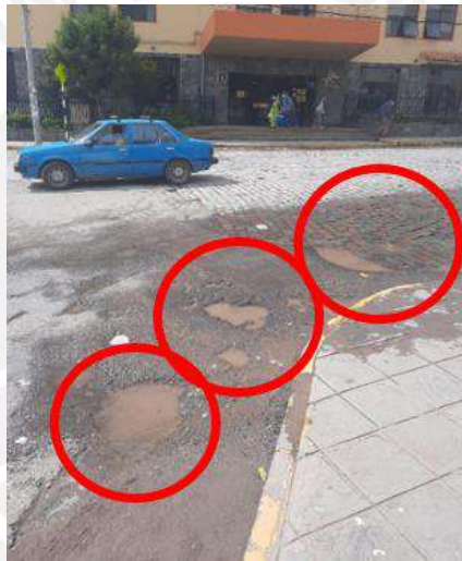
Figura 24. Baches en la avenida Pardo - Paseo de los Héroes. Fuente: propia
