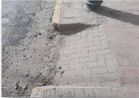
Foto 109: Rampa peatonal con pendiente elevada en la alameda Pachacutec.
