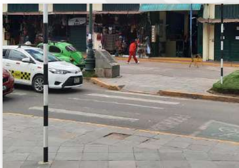
Foto 107: Ausencia de rampas de llegada en el refugio peatonal ubicado en el cruce de las avenidas El Sol y Tullumayo.
