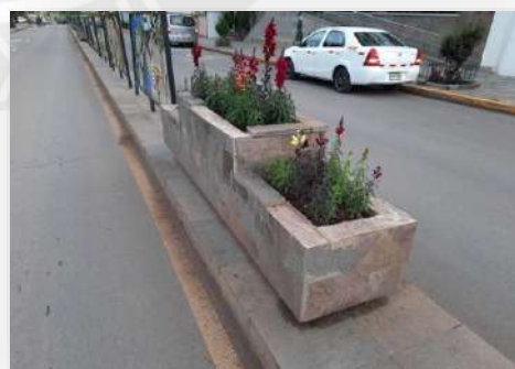
Foto 168: Maceteros dañados en la avenida El Sol.
