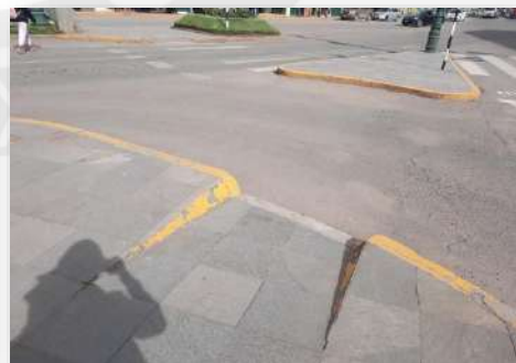
Foto 108: Ausencia de rampas de llegada en el refugio peatonal ubicado en el cruce de las avenidas El Sol y Tullumayo.
