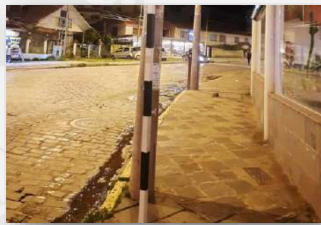
Foto 166: Postes de cableado eléctrico ubicados en el borde de la acera, avenida Pardo.
