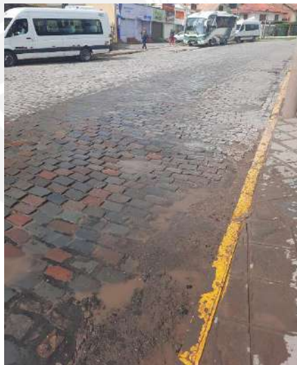
Figura 18. Ausencia de señalización horizontal en la avenida Pardo - Paseo de los Héroes. Fuente: propia.
