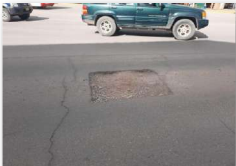
Foto 61: Hueco rectangular a la altura del restaurante "Condorito" en la intersección.
