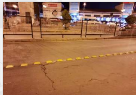
Foto 40: Carencia de retroreflectividad en las tachas longitudinales de la avenida El Sol.
