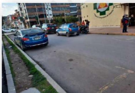
Foto 81: Demarcaciones horizontales desgastadas en la zona de estacionamiento, avenida Tulumayo.
