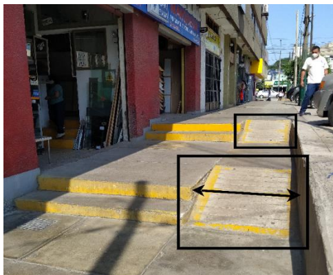
Figura 41: Desniveles en acera Jr. El Álamo. Fuente: Propia (2021)
