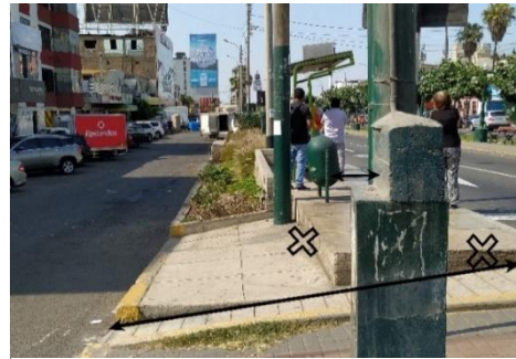
Figura 54: Deficiencias en paradero. Fuente: Propia (2021)
