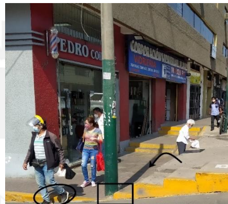
Figura 42: Deficiencias en acera Jr. El Álamo. Fuente: Propia (2021)
