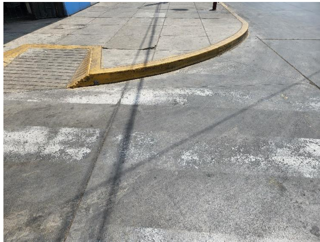
Figura 29. Cruce peatonal sin mantenimiento ni repintado. Fuente: Fotografía propia. 02 de abril del 2022.
