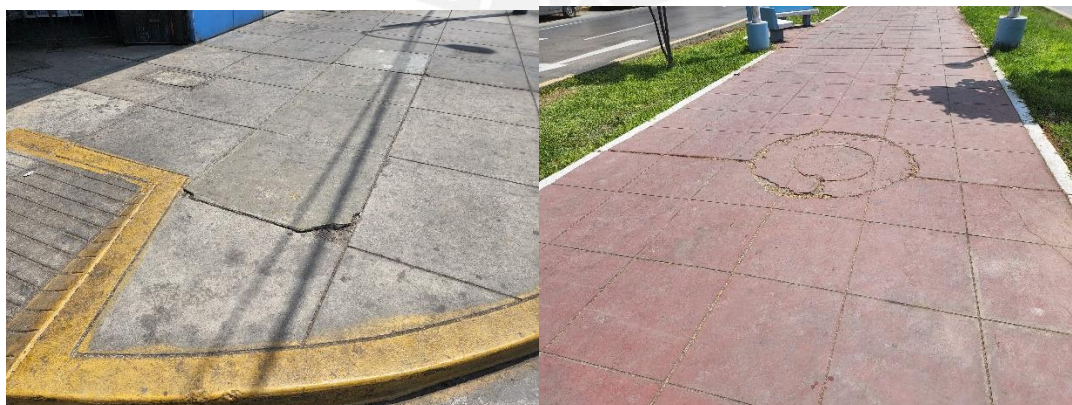
Figura 25 y 26. Estado de conservación de veredas.
