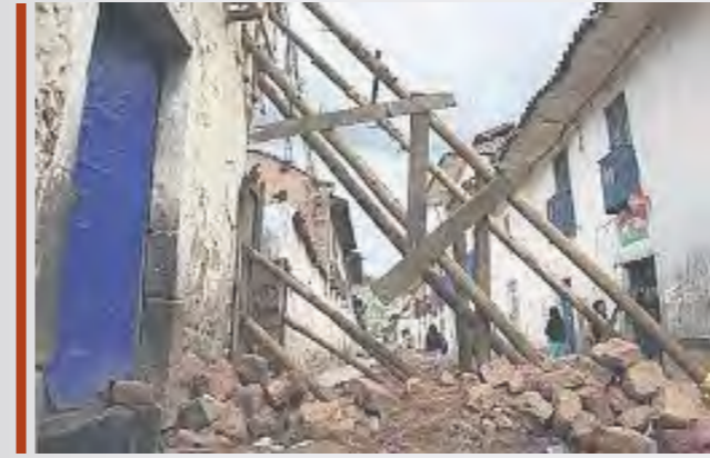
Estructura que busca frenar el colapso inminente de una fachada de vivienda.
