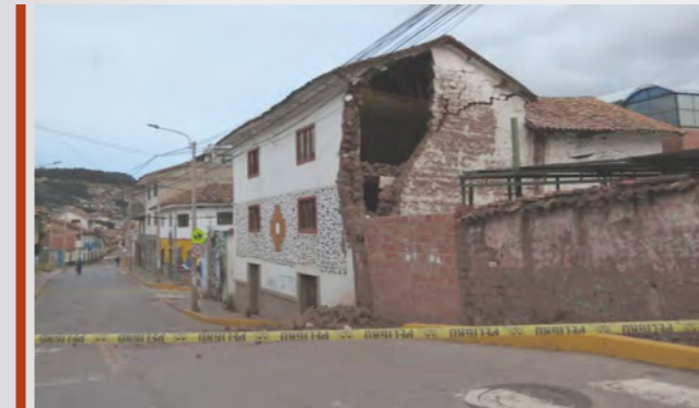
Muro medianero de vivienda colapsado como consecuencia de un sismo.
