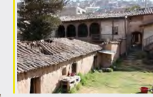
Daños y deterioro en muros y techos de las viviendas.
