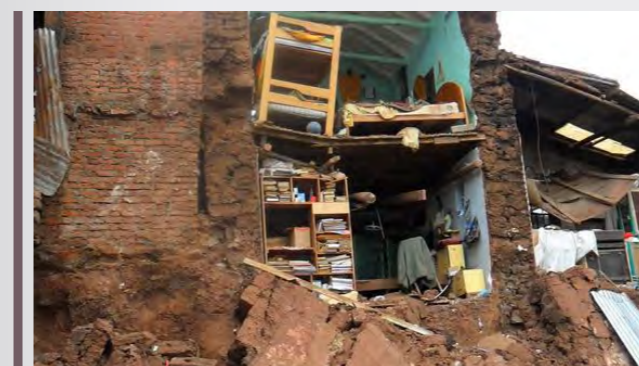
Colapso de la vivienda
