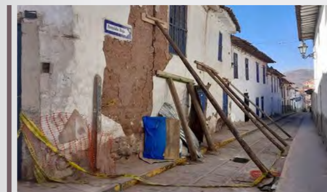
Colapso de los muros de vivienda.
