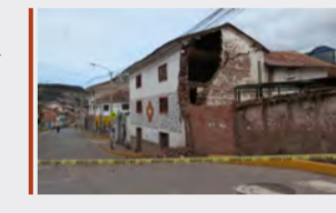
Muro medianero de vivienda colapsado como consecuencia de un sismo.
