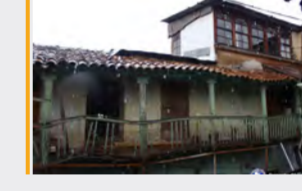
Deterioro de las galerías de los patios de vivienda.
