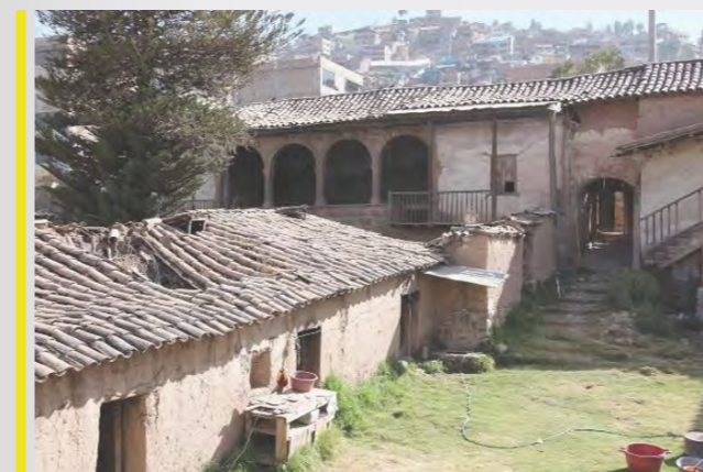
Daños y deterioro en muros y techos de las viviendas.
