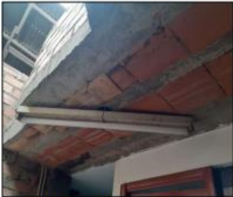
Baja calidad en el techo
