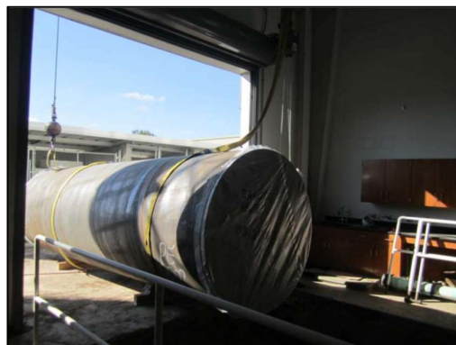
Figura 4-4: Tubería en el laboratorio de CUIRE, (SHARMA, 2013).
