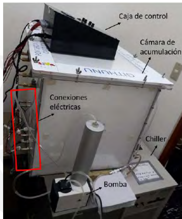
Figura 4.1: Cámara de acumulación, caja de control de temperatura y humedad, chiller y bomba.
