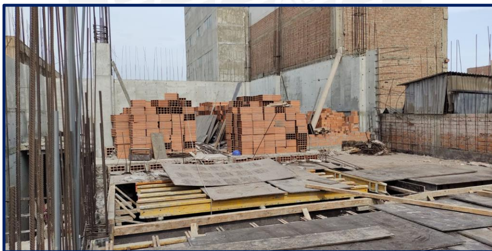
Figura 3.9: Material fenólico con deformaciones significativas que afectan su resistencia Fuente: Elaboración propia, 2022
