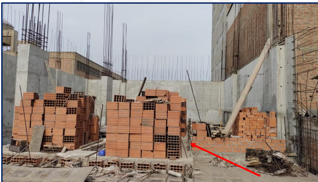
Figura 8.10: Ladrillo retirado por pérdida de resistencia Fuente: Elaboración propia, 2022
