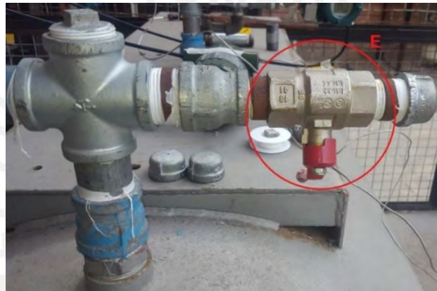
Figura 2.8 – Válvula E al final de la línea para descarga del tanque.
