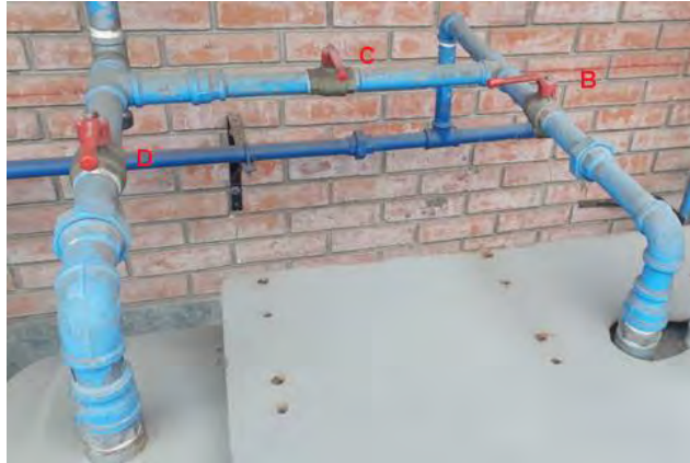
Figura 2.7 – Válvulas B de carga y válvulas de aislamiento (C y D) del tanque de aire comprimido.
