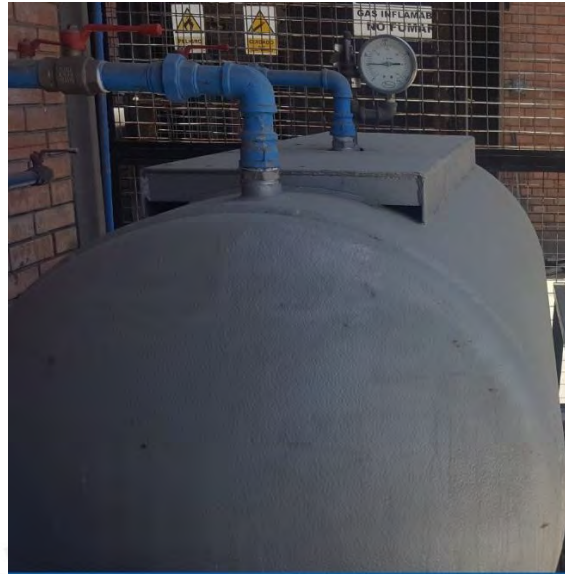
Figura 2.5 – Tanque de almacenamiento de 1 m 3 del LABEN.
