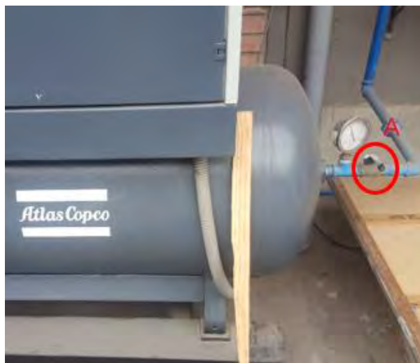
Figura 2.6 – Válvula A de aislamiento del compresor del sistema.
