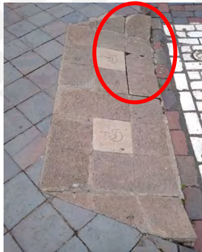
Figura 30. Estado actual de rampa R6. Fuente: Propia.
