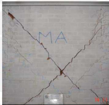
Figura 2.5: Falla final del muro de arcilla (Angles, 2008).
