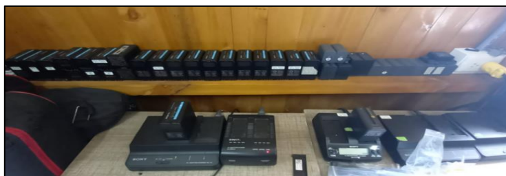
Figura 36: Zona de baterías externas
