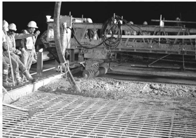
Figura 2.11. Losa de puente con GFRP del puente Sierrita de la Cruz (ACI, 2007)
