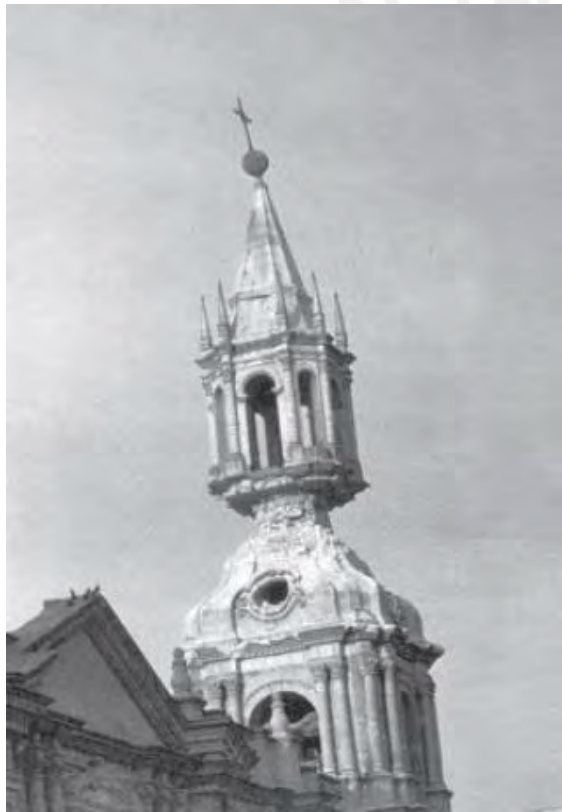
Figura 2.19. Torre afectada por sismo en Arequipa, Perú (Tumialan et al., 2003)
