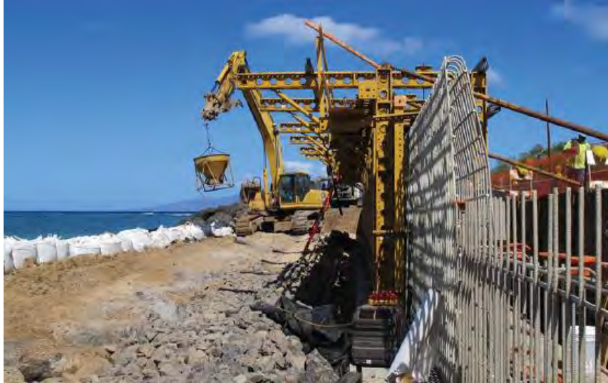
Figura 2.12. Muro de protección de la autopista Honoapiilani, Hawai, USA (Nanni et al., 2014)
