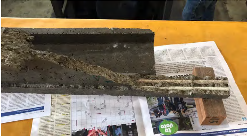
Figura 6.9. Detalle del deslizamiento y separación por pérdida de adherencia en el apoyo
