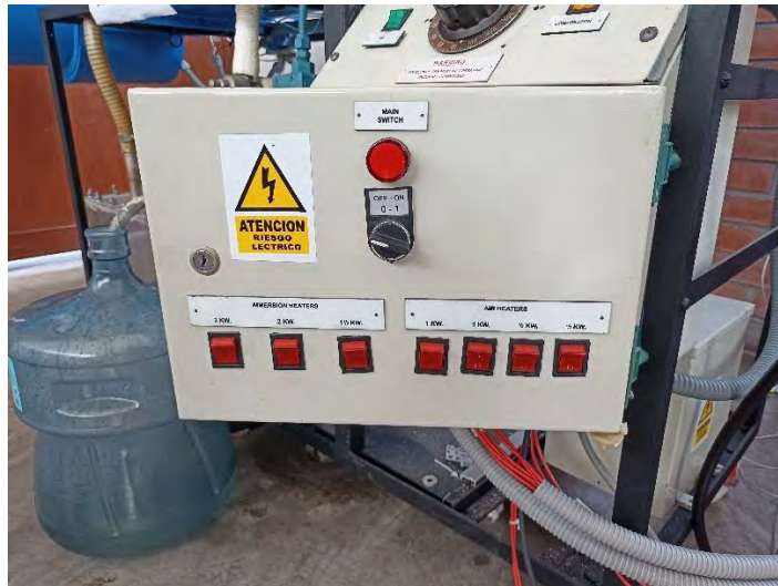
Figura 2.16. Tablero de control del equipo a ser controlado remotamente Fuente: fotografía propia
