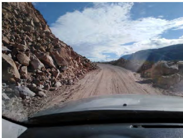
Figura 6. Curva angosta con ancho inadecuado y derrumbes. Fuente: Propia.
