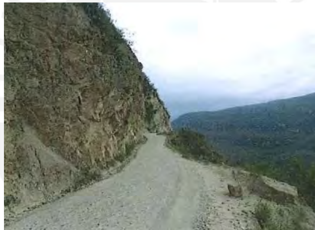
Figura 4. Punto crítico donde existen deslizamientos de roca constantes. Fuente: Propia
