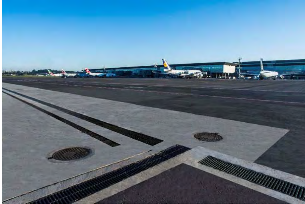
Figura 15. Canales de drenaje en el Aeropuerto Guarulhos en São Paulo– Brasil
