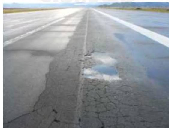
Figura 28. Carpeta asfáltica del aeropuerto dañada.
