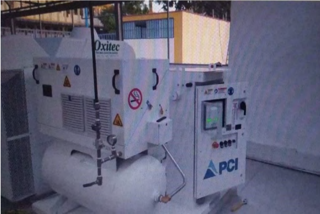
Foto N° 3: Generador de oxígeno
